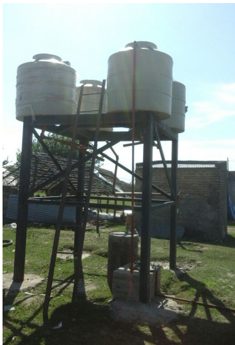
Sistema de elevación a tanques de reserva.
