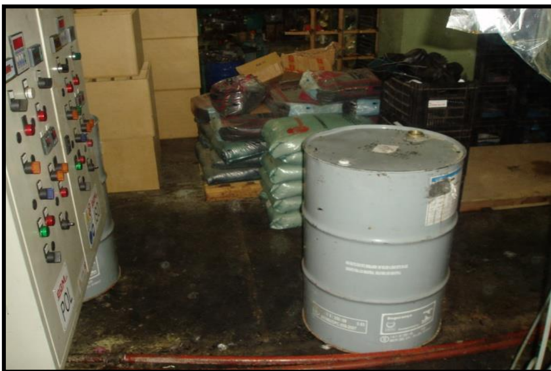
Accesorios de inyectora, Tableros de inyectora
