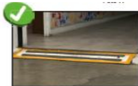
Aun los desniveles pequeños deben salvarse con una rampa. En los ejemplos superiores, las rampas se señalaron con un color contrastante, una tira antiderrapante y algo de suma importancia: las rampas son del mismo ancho que las puertas.
