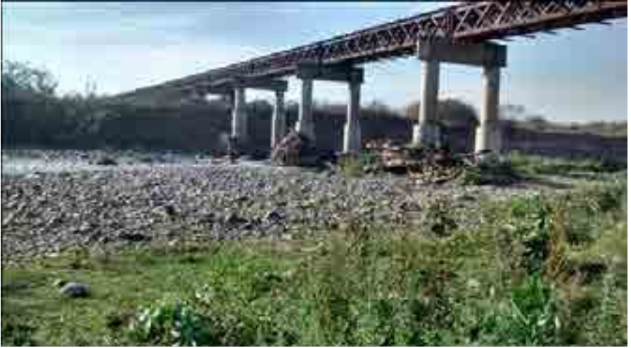
Fig.1 – Puente del Ferrocarril Mitre sobre el Río Salí, donde se observa los pilotes desprovistos de material árido y un importante bajante del nivel de base del río.
